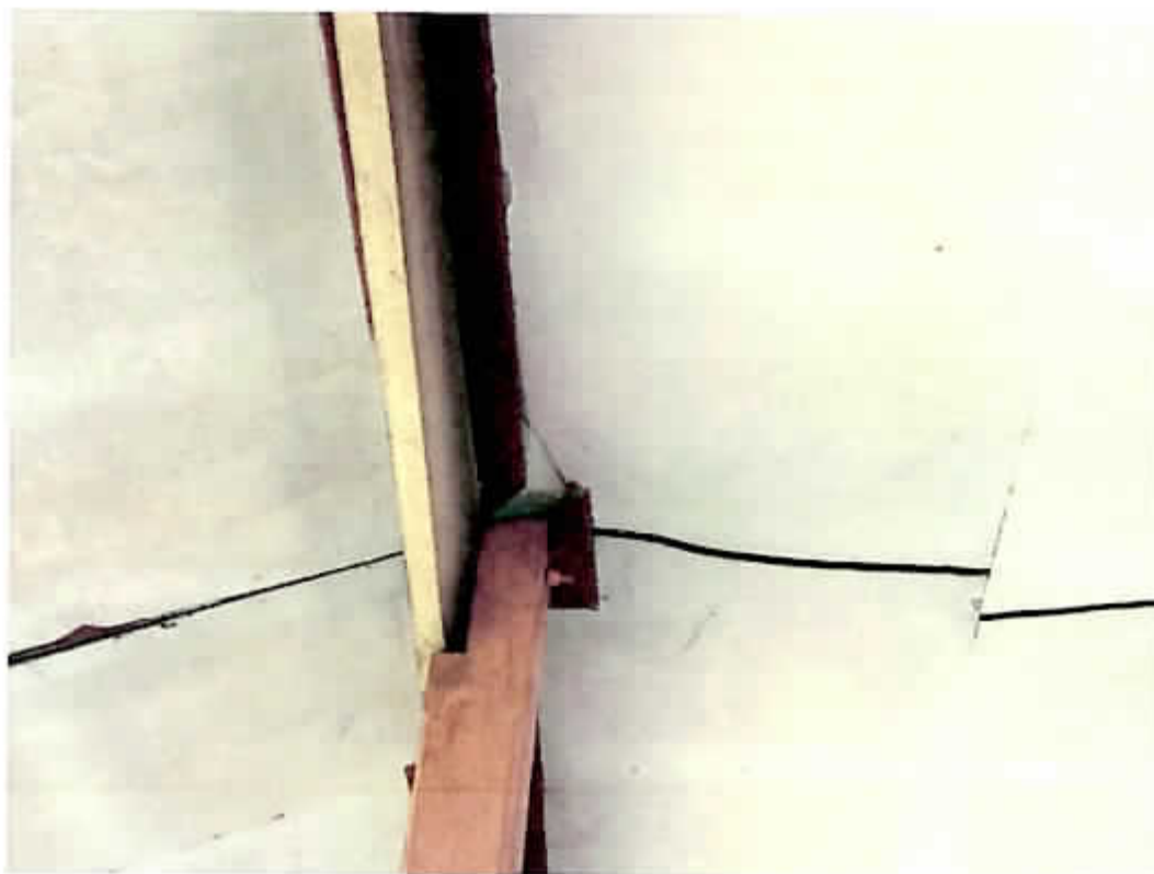
รอยแยกตรงกลางอาคาร
